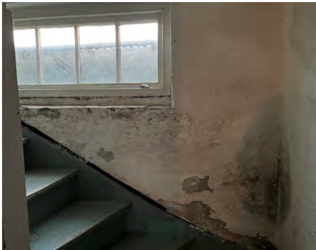
Figur 85 - Fukt i grunnmur på grunn av manglende drenering.
