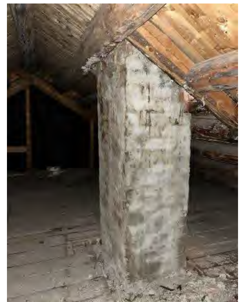
Figur 88 - Skader på pipen.
