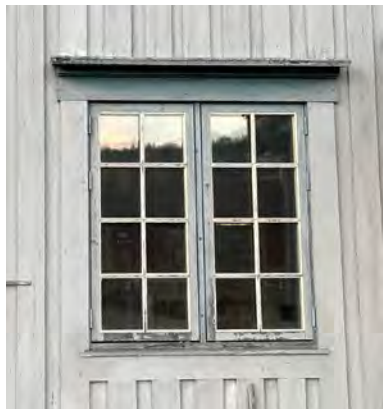
Figur 89 – Manglende vedlikehold av vinduer.
