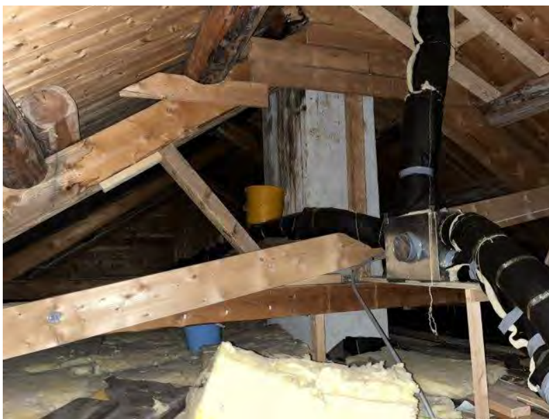
Figur 87 - Vannskade på loftet.
