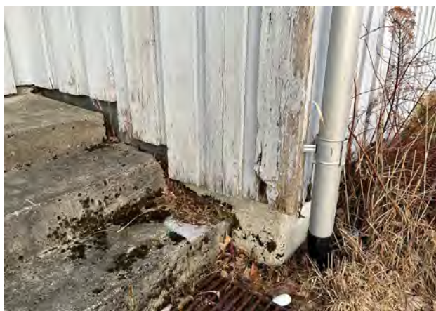
Figur 92 – Råte i kledning på værutsatt vestfasade.
