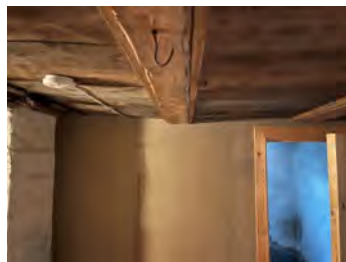
Figur 69 – Setningsskader i gangen.
