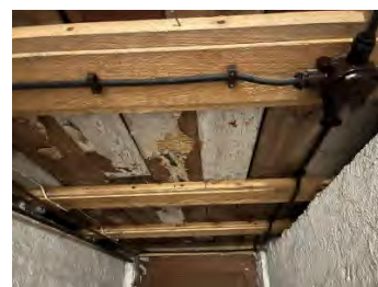
Figur 70 – Eldre elektrisk anlegg.
