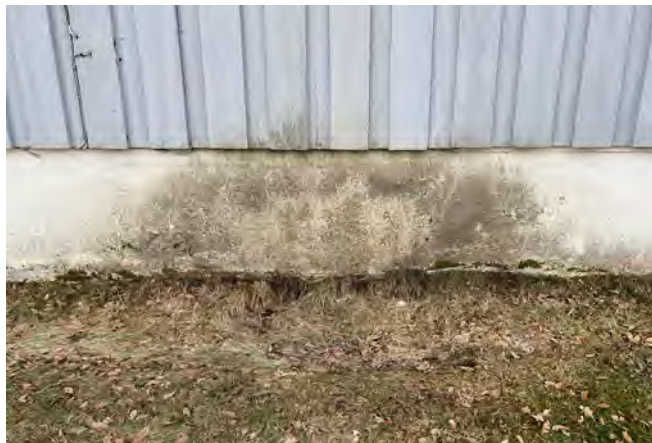
Figur 93 – Fukt i grunnmur. (Her kan det ha vært vegetasjon som er fjernet.)
