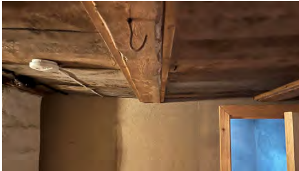
Figur 83 - Setningsskader i kjelleren.
