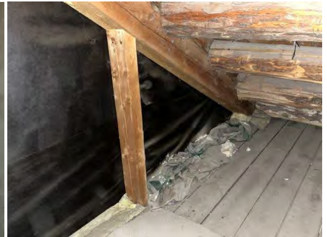
Figur 86 - Midlertidigtetting av sprekk på loftet.
